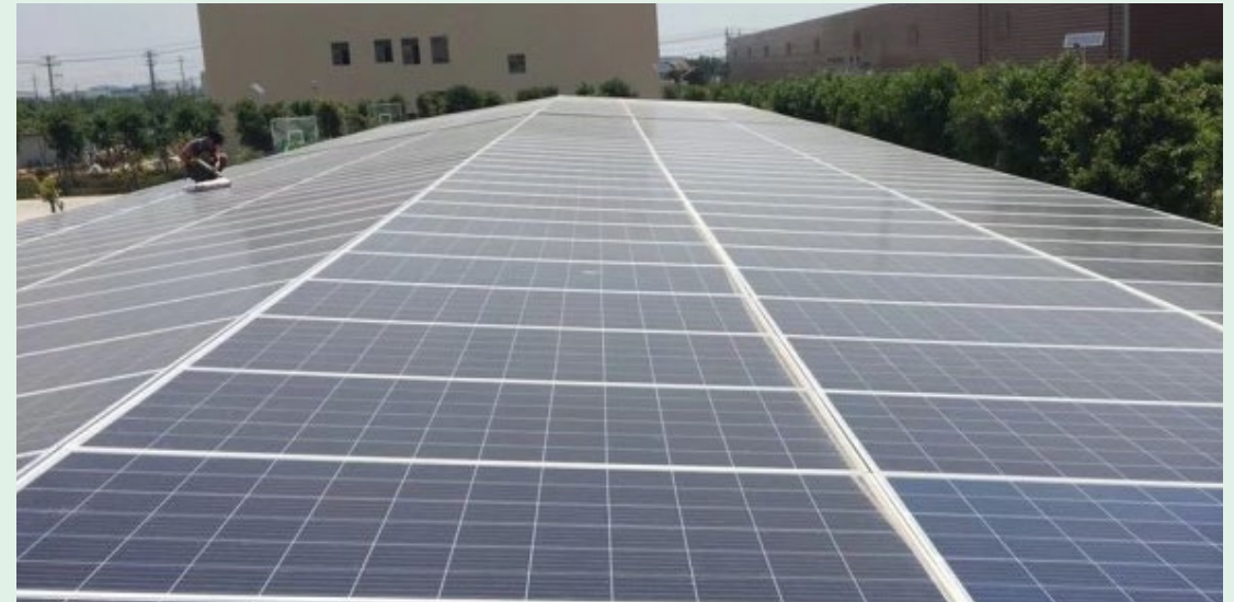
赣锋电池厂顶部太阳能光伏板
